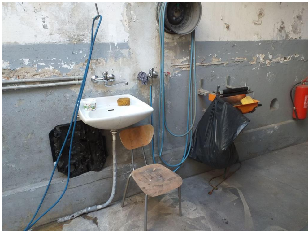
Foto č. 27: Technické zajištění pro oplachování aut v garáži vnitrobloku
