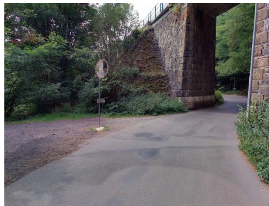
Obrázek 57 podjezd železnice na silnici II/201 v Křivoklátu je při Q_{100} zaplaven, ř. km 0,20
