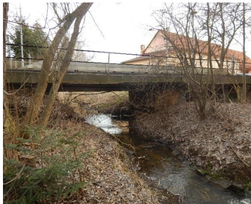
Obrázek 28 silniční most v Oráčově omezující proudění vody, ř. km 31,4
